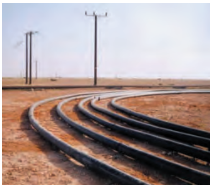
Рис. 2. Трубопроводы надземной прокладки, проработавшие 14 лет
