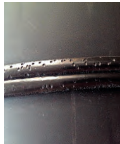
Рис. 3. Сварной шов труб, изготовленных из ПЭНП, имеющий дефекты в виде раковин на внешней поверхности
