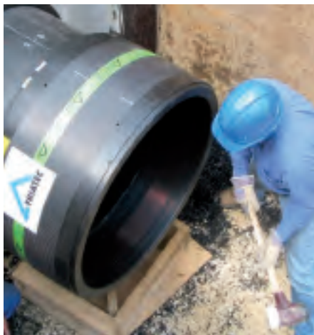
Рис. 1. Соединения при помощи цилиндрическими муфтами требуют приложения больших физических усилий из-за больших допусков
