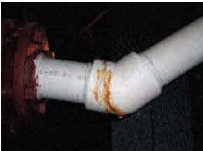
Рис. 1. Грубые нарушения технологии сварочно-монтажных работ привели к саморазрушению трубопровода из полипропиленовых труб течение нескольких месяцев после начала эксплуатации.
