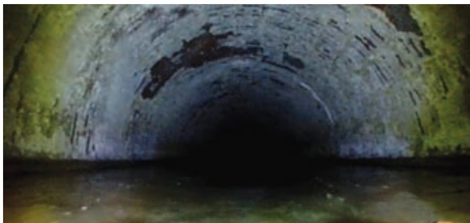
Рис. 1 Состояние внутренней поверхности коллектора
