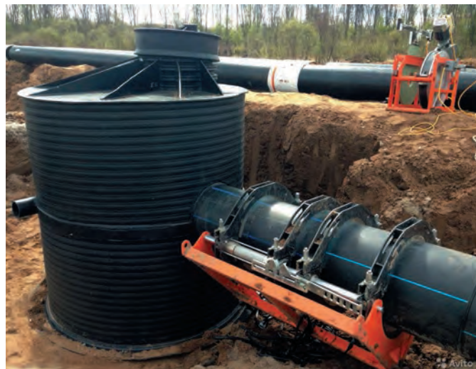
Рис. 2. Жесткая опора под центратором отсутствует
