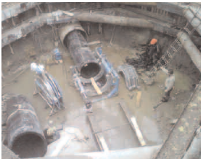
Рис. 3. Конструкция основания очень ненадежна
