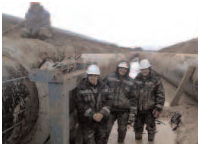
Рис. 2. Грязь препятствует качественной сварке
