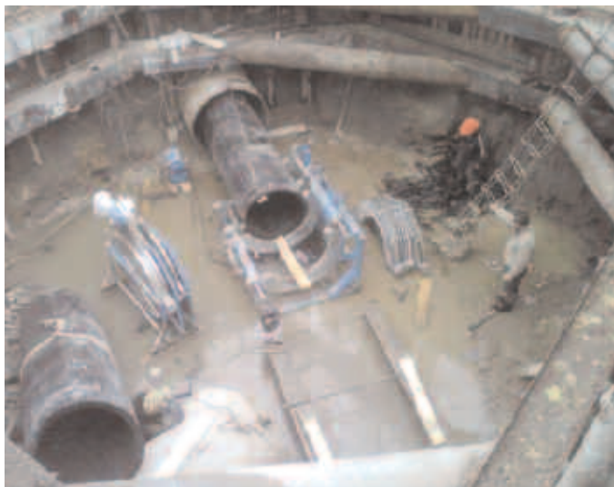
Рис. 3. Конструкция основания очень ненадежна
