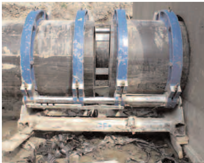
Рис. 4. Нарушение центровки труб
