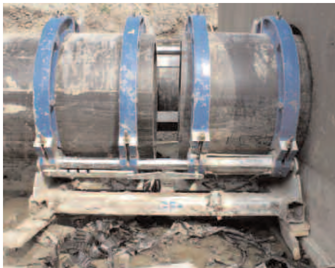
Рис. 4. Нарушение центровки труб
