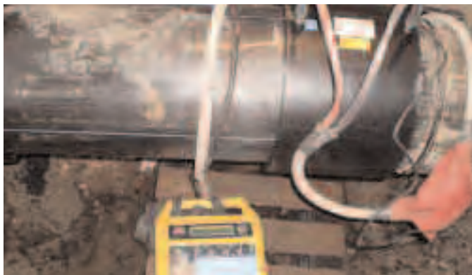
Рис. 7. Пример нарушения основных норм подготовки деталей под сварку ЗН
