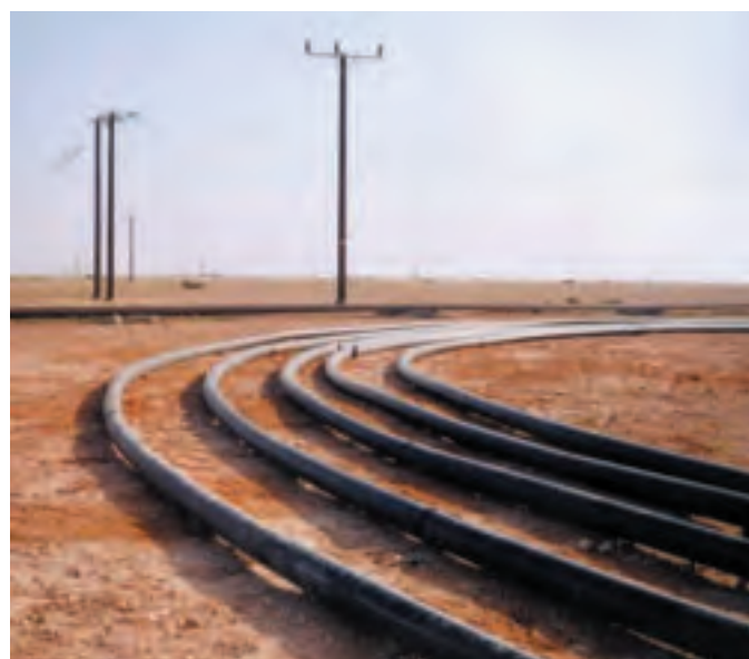
Рис. 2. Трубопроводы надземной прокладки, проработавшие 14 лет
