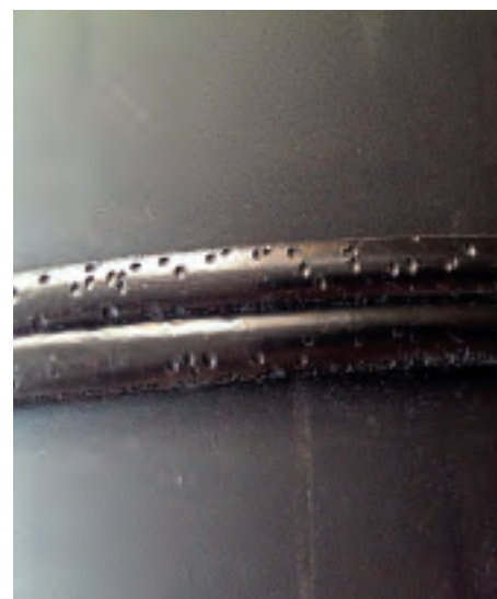
Рис. 3. Сварной шов труб, изготовленных из ПЭНП, имеющий дефекты в виде раковин на внешней поверхности
