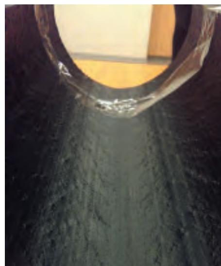
Рис. 2. Труба, изготовленная из ПЭНД, имеющая дефекты в виде закрытых пор на внутренней поверхности
