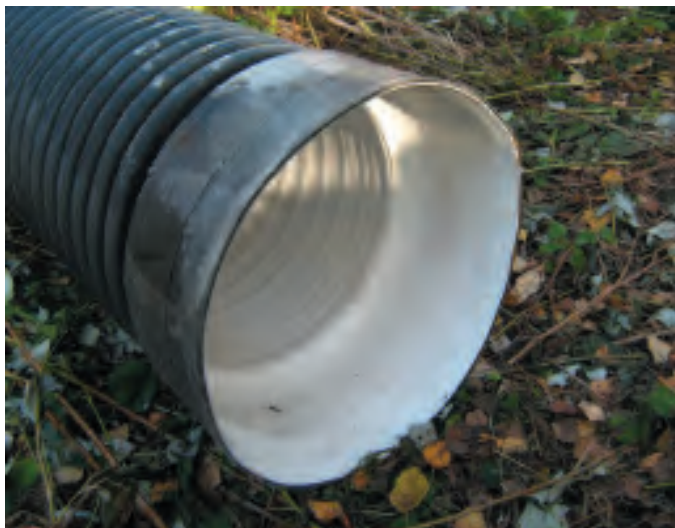
При нарушении условий транспортировки и хранения труб формованный раструб часто деформируется
