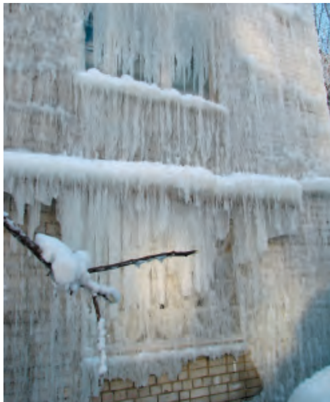
Последствия аварии на тепловой сети надземной прокладки
