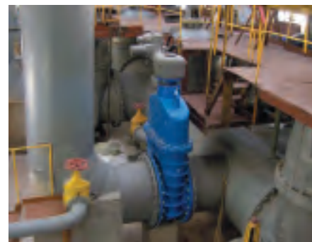
Клиновая задвижка Ду 800 на канализационной насосной станции в Москве.
