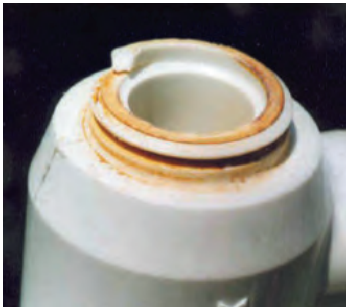
Полибутеновая труба, разрушившаяся в результате реакции с хлором в воде.
