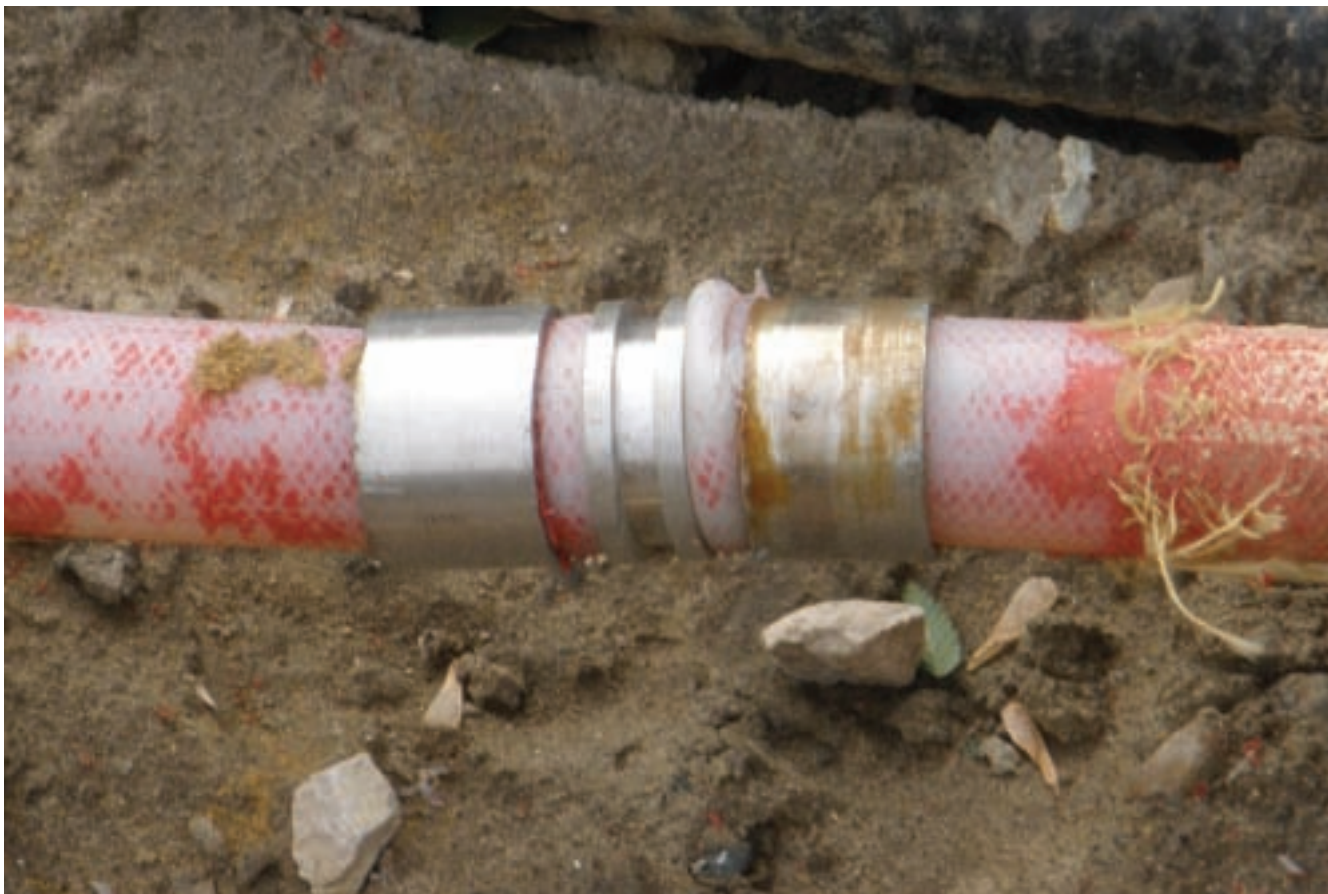
Рис. 1. Случай грубого нарушения технологии монтажа стыка трубы ИЗОПРОФЛЕКС®-А
