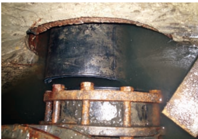
Рис. 1. Разрушение стыкового соединения трубы и втулки из-за нарушения технологии сварки
