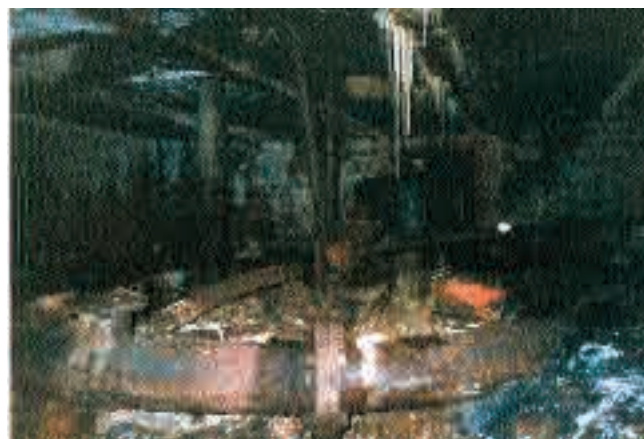
Рис. 3. Внутреннее пространство павильона фонтана с кольцевой медной распределительной трубой, приточными и выпускными трубами. 1998 г.
