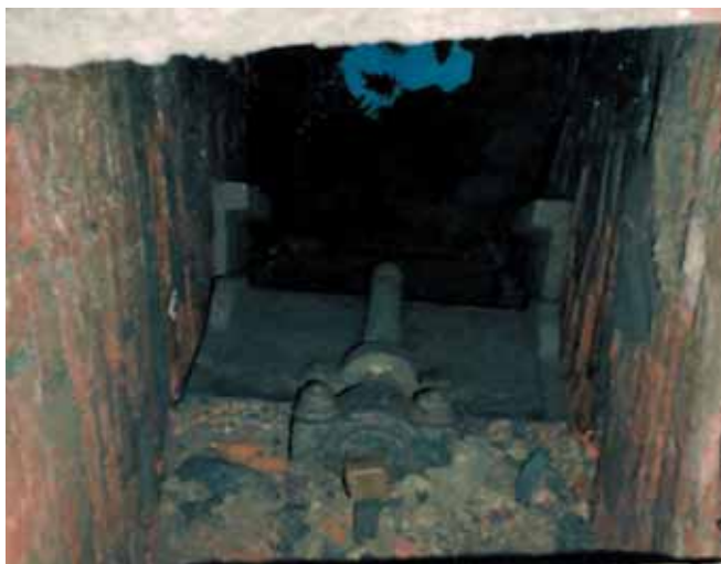
Рис. 7. Фрагменты «щита с подъемным домкратом», установленного в канале
