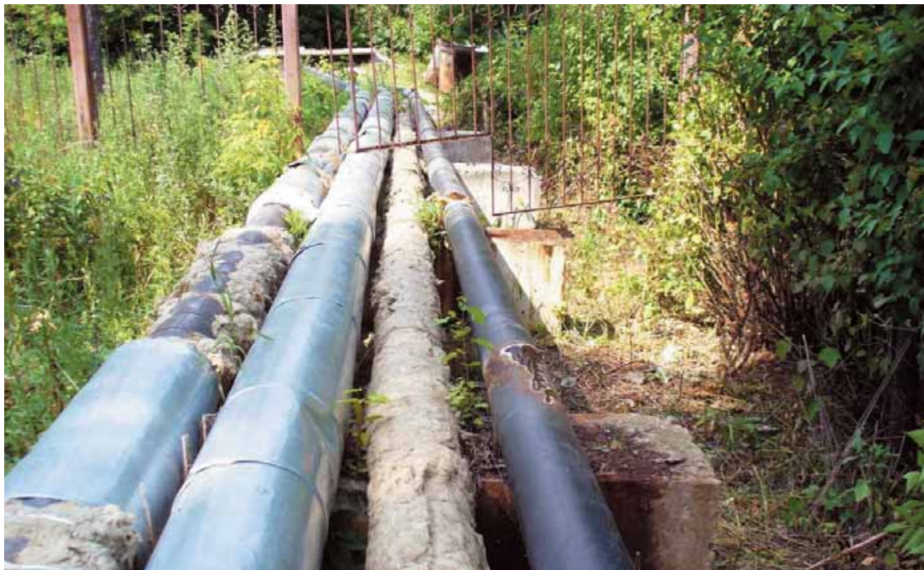
Теплотрасса от котельной №22 г. Дзержинска до замены стальных труб ГВС на полипропиленовые
