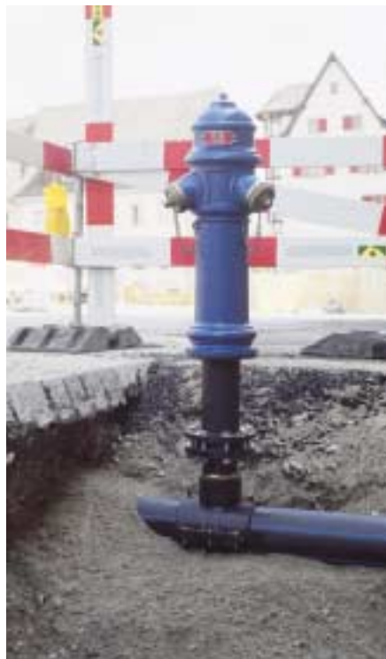
Рис. 3. Подключение гидранта с помощью седлового отвода
