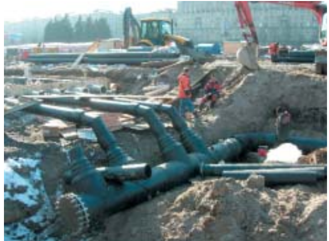
В кратчайшие сроки именно из ПЭ труб были изготовлены и поставлены сложнейшие узлы для фонтанного комплекса на площади у станции метро «Московская» в Санкт-Петербурге
