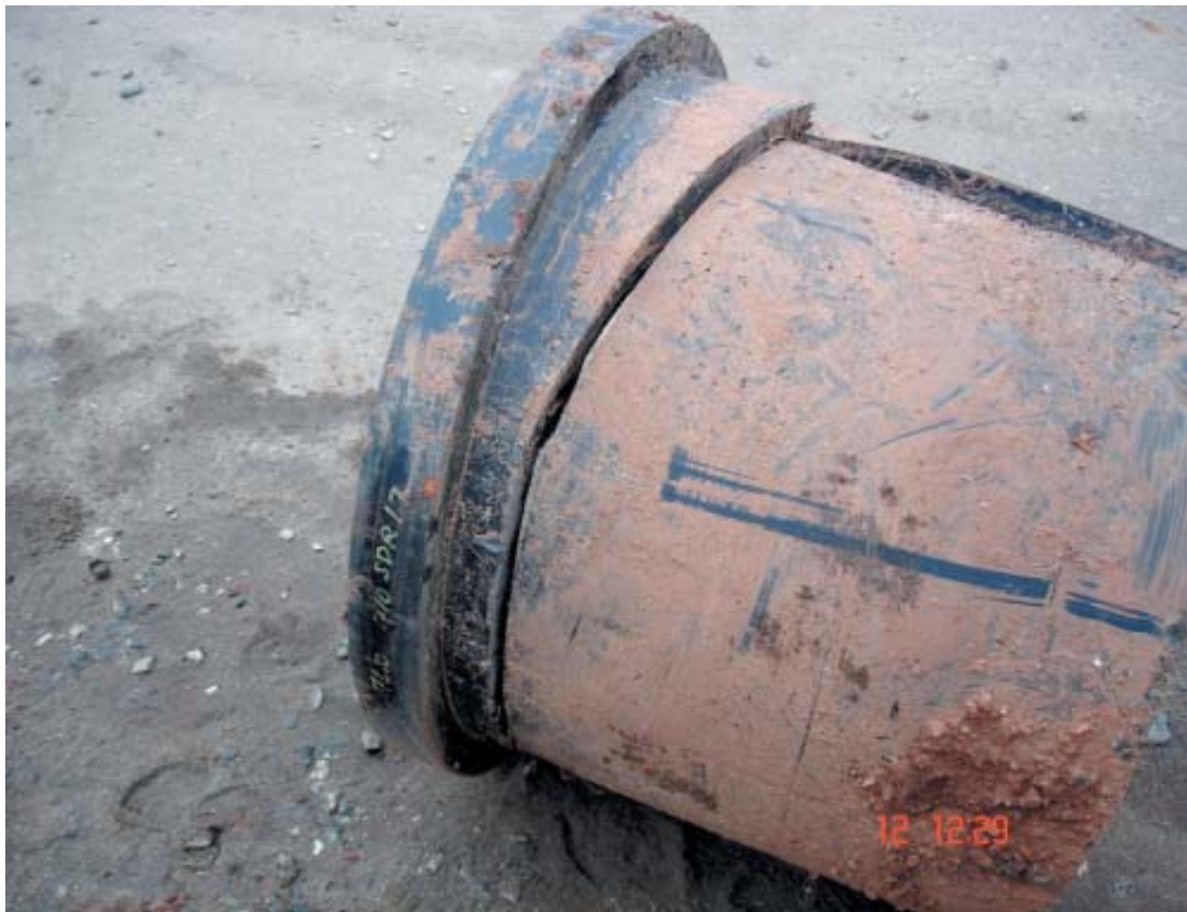
Рис. 1. Разрушенное соединение трубы ПЭ 80 Ø710 мм SDR 13,6 со втулкой ПЭ 100 SDR 17.
